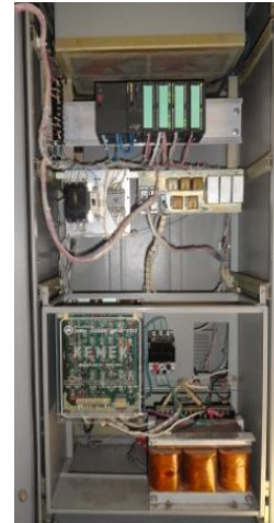
Рисунок 4 – Внутрішній вигляд переобладнаної шафи «Контур 1»
